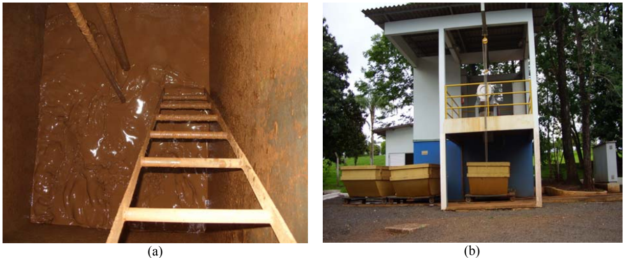
Figura 3.3 – (a) Lodo sendo descarregado pelo decantador, (b) Maquinário de centrifugação com acondicionamento em contêineres.
