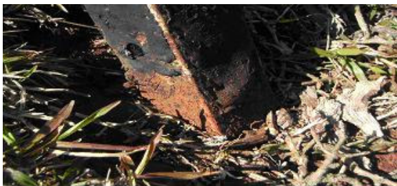
Figura 2: Evidências de corrosão no pé da torre 570 (ASTM 2668)
