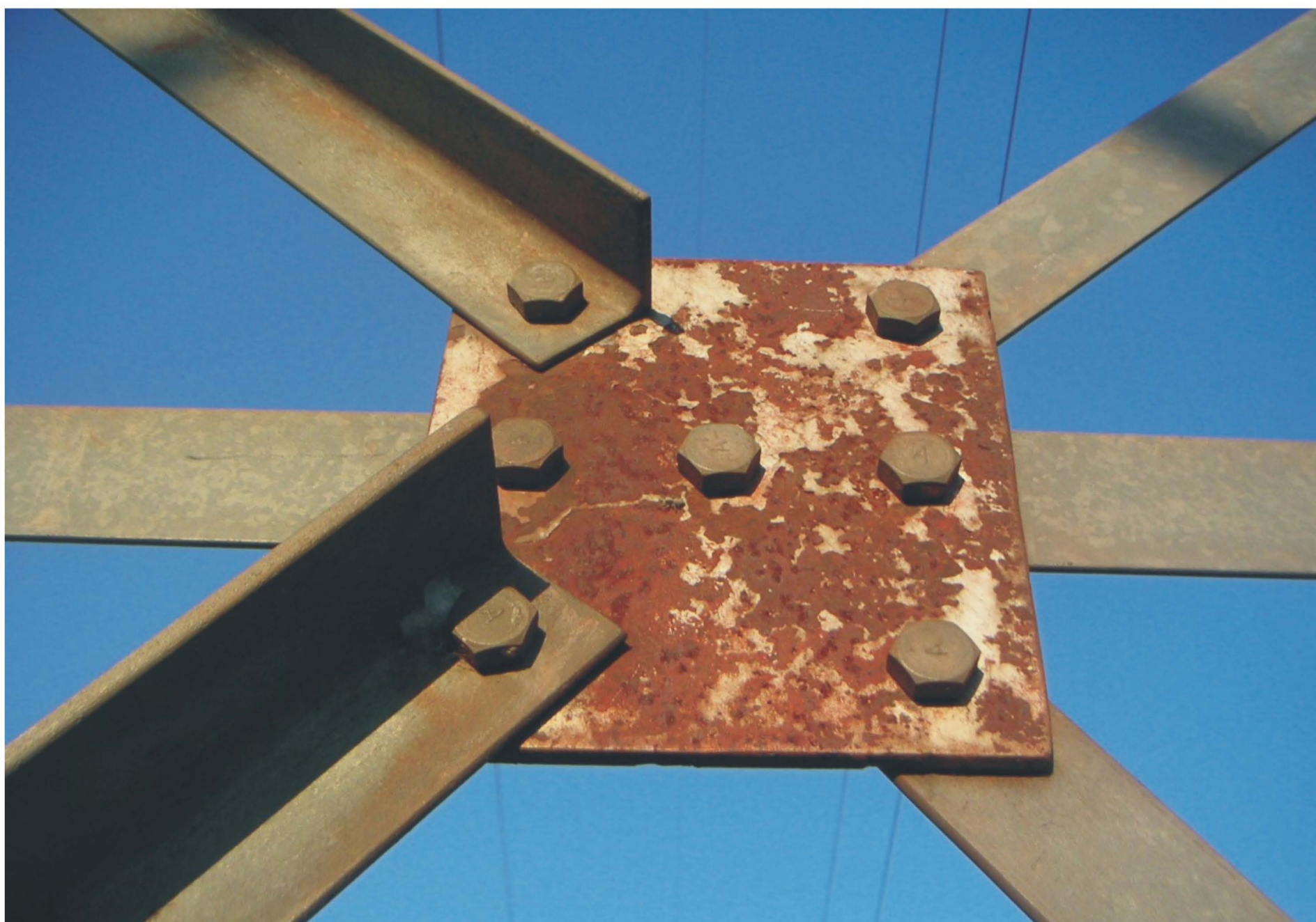
Figura1 - Evidências de corrosão nas ferragens aéreas da estrutura da torre #648 da Linha de Transmissão Acaray-Oviedo-Py
