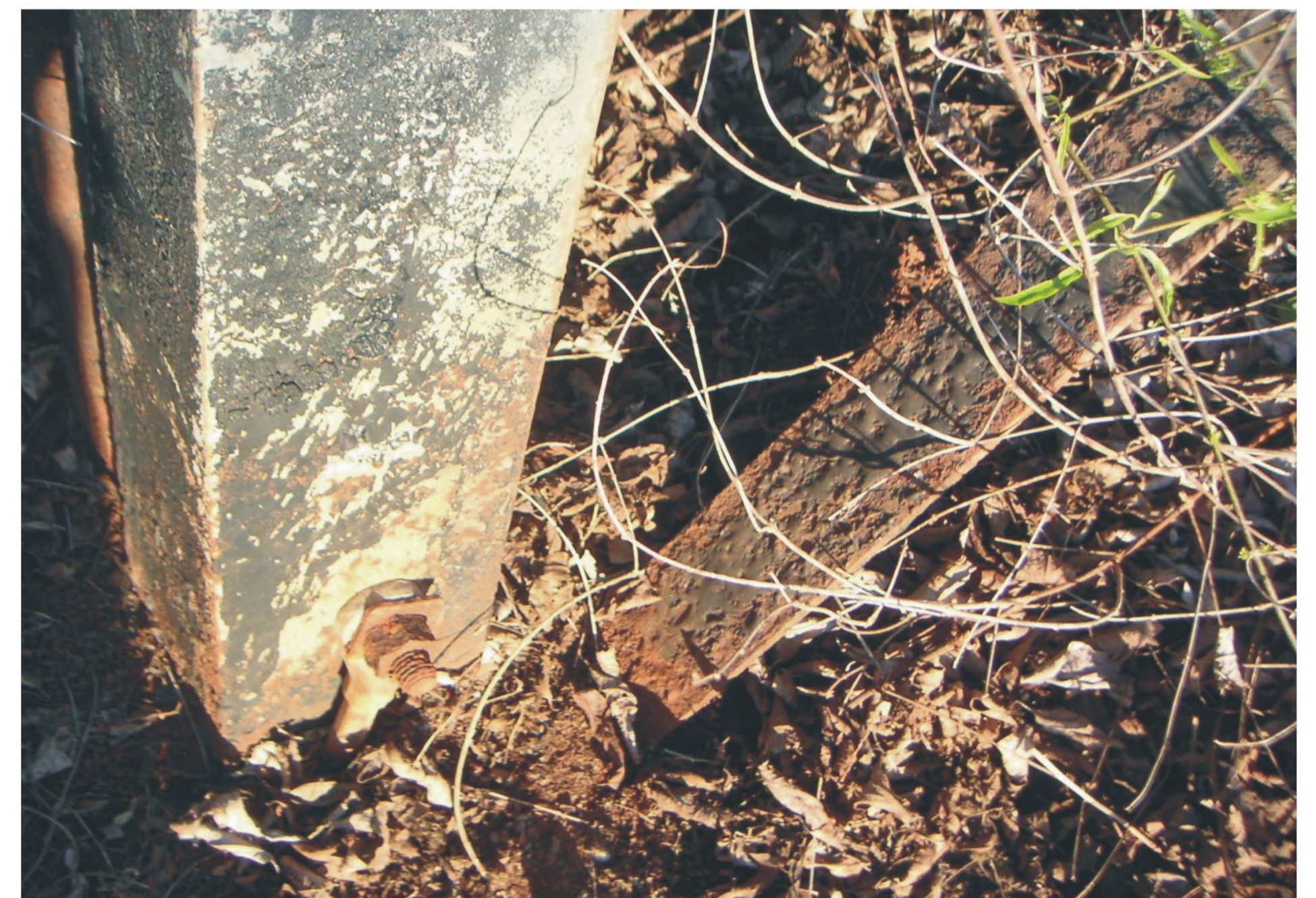
Figura 3 - Presença de corrosão no pé da torre #629
