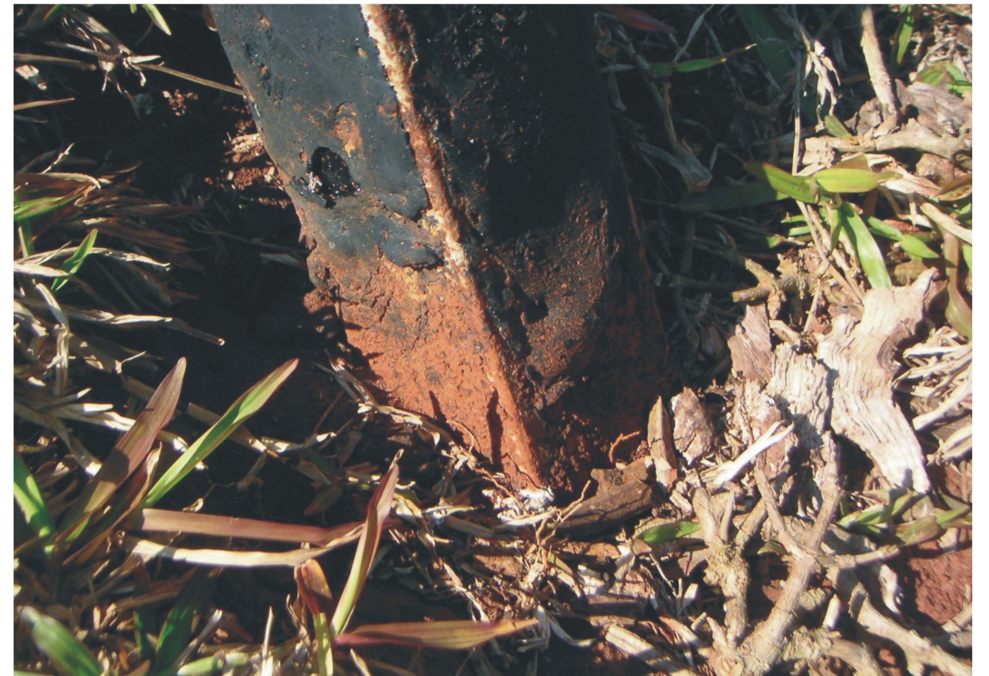
Figura 2 - Evidências de corrosão no pé da torre #570
