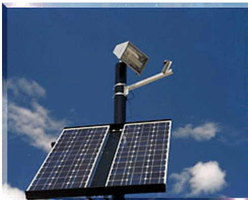
FIGURA 13 – Um módulo fotovoltaico de 100 W, para alimentação de um candeeiro público usando baterias de 12 V.
